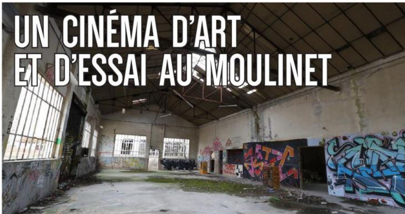
L'ancienne salle devrait être détruite pour faire place à un bâtiment à énergie positive abritant le nouveau cinéma d'art et d'essai de l'agglomération troyenne. Photos Jérôme BRULÉY
